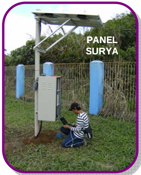
Foto Instalasi komunikasi GPS, menggunakan jaringan GPRS.
